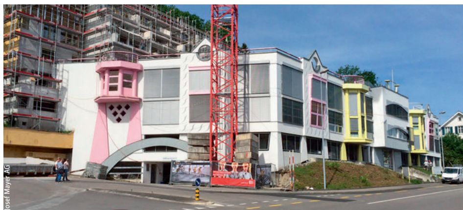
Die «farbenfrohe» Fassade vor der Sanierung.
